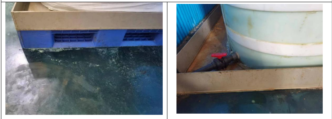
车间防腐、防渗漏托盘
